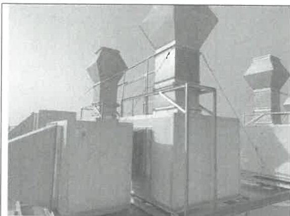
废气处理设施
